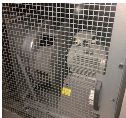
清浄に保たなければならない換気システムのポンプ
