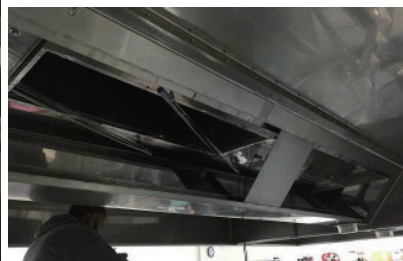
紫外線システムを設置した厨房フードの内部
