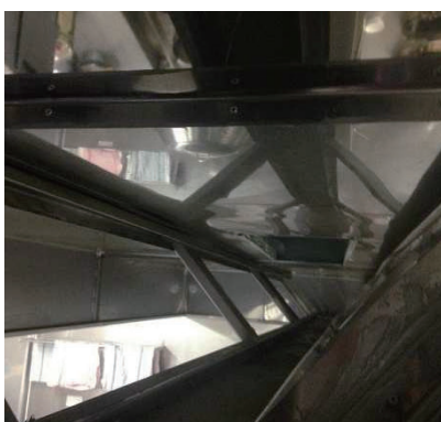
紫外線システムなしの厨房フードの内部
