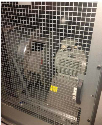
Pumpe der Lüftungsanlage – muss sauber bleiben
