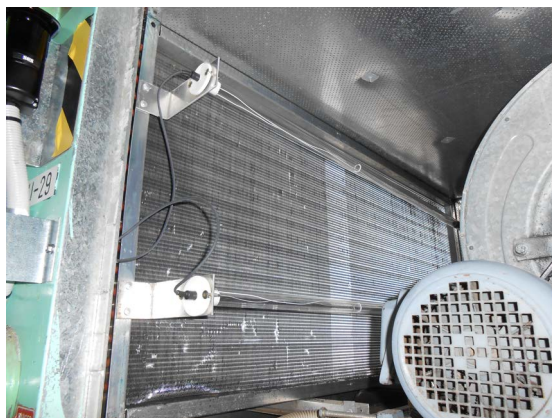
Anlage nach dem Einbau der Luftdesinfektionsstrahler Foto: Beyond Energy Solutions
