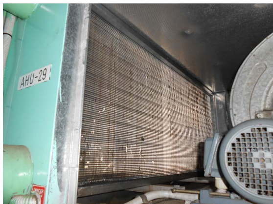
Anlage vor dem Einbau der Luftdesinfektionsstrahler Foto: Beyond Energy Solutions
