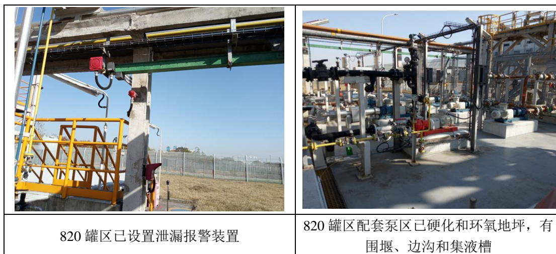
图 4.3-7 罐区现场照片
