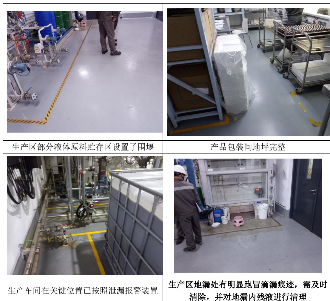
图 4.1-4 有机生产车间（HPP-CP）装置现场照片
